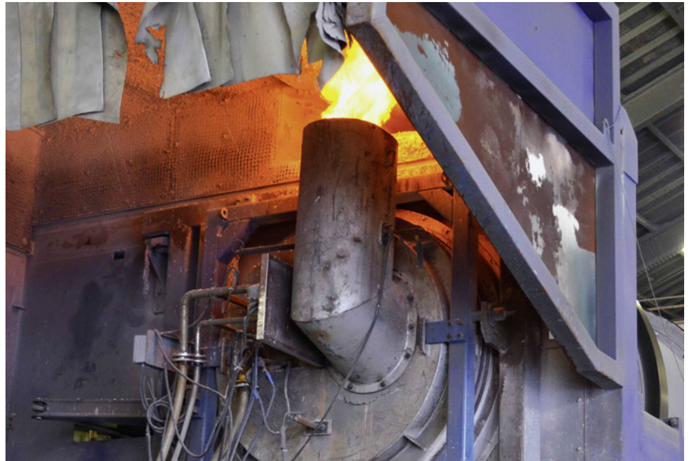
Das BHKW versorgt seit Juni dieses Jahres das Werk 3 der Aluminium Rheinfelden GmbH mit Strom, Wärme und Kälte.
