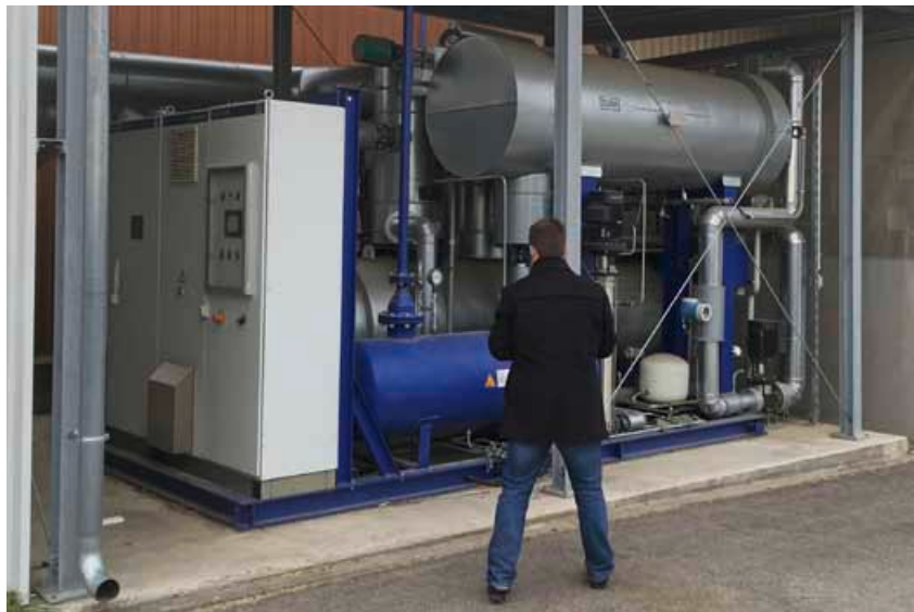
ORC-Anlage in Kornwestheim mit einer Anlagengröße von 50 kW HT KWK. Anwendung: Biogas; Wärmequelle: Motorabgas
